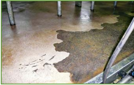
Résine sur quai qui se décolle
