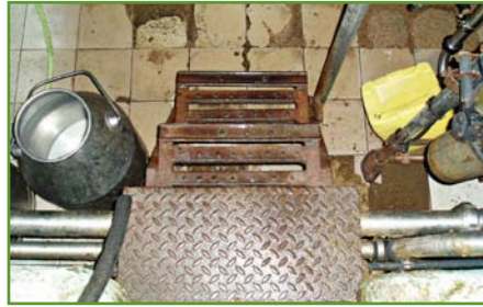
Carrelage dégradé en fosse de traite
