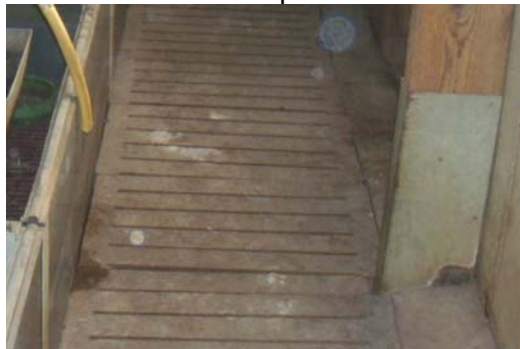
ici le poteau réduit la largeur de passage d'un chariot
