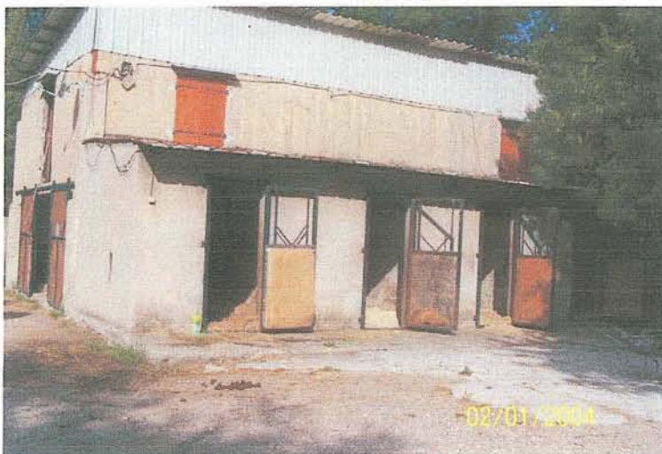
Ecurie très dégradée
